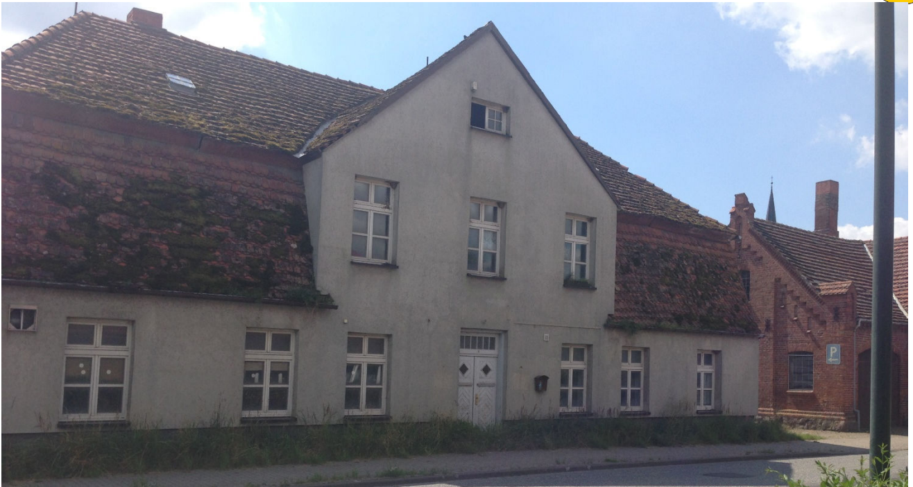
Dorfstraße 54: im Bestand gefährdet, Denkmal, komplett leer stehend
