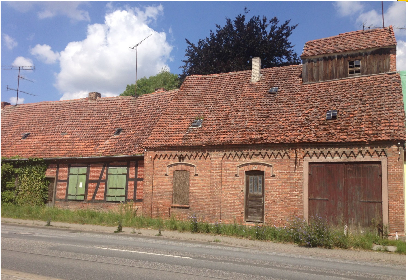
Dorfstraße 19: im Bestand gefährdet, Denkmal, komplett leer stehend
