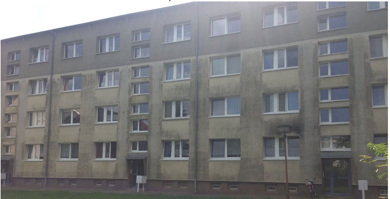
Schlossstraße 7-9: schlechter Bauzustand, 17 % Leerstand
