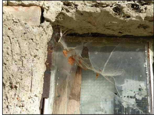
Abb. 4: Altspinnweben und zerbrochenes Fensterglas.
