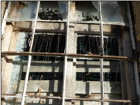
Abb. 5: Drahtgeflecht verjüngt die Einflüge. Erhöht die Verletzungsgefahr.
