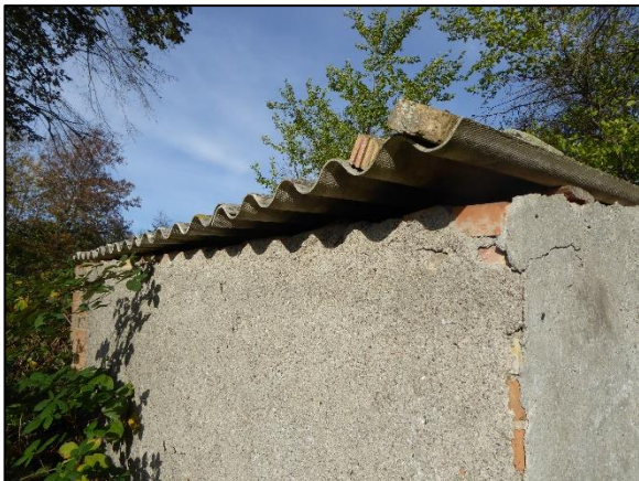
Abbildung 13: Einflugmöglichkeit zwischen Dach und Mauerwerk.
