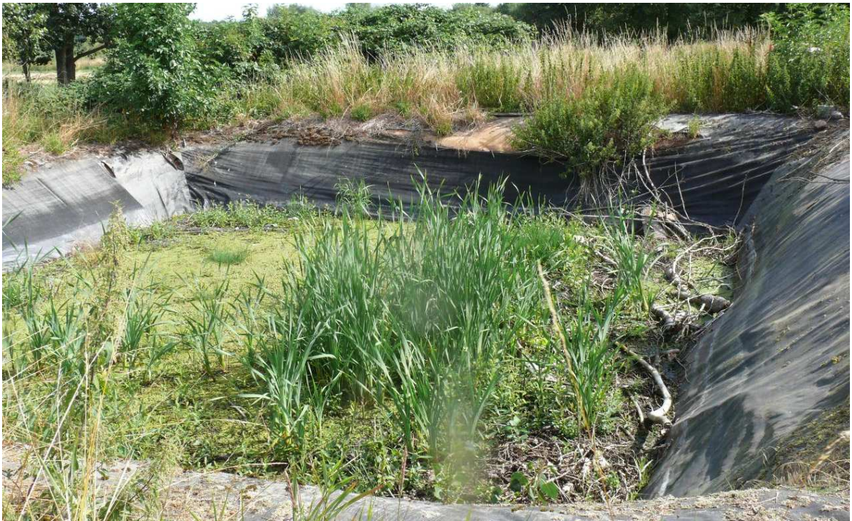
Foto 6: Feuerlöschteich mit BS 7/22 (Hintergrund)
