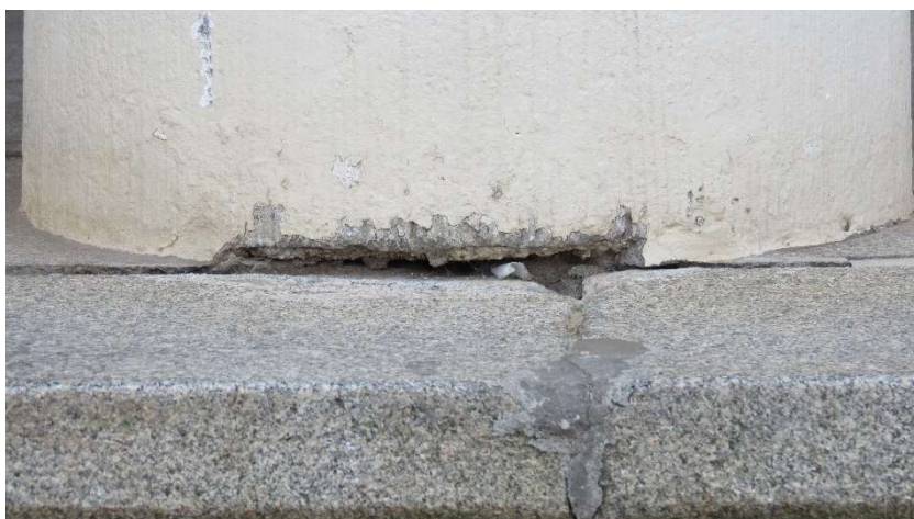
Abplatzungen am Säulenfuß
