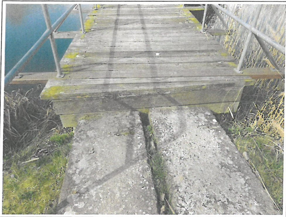
Zugang – Höhenunterschied 25 cm, Spalt zwischen Betonplatten
