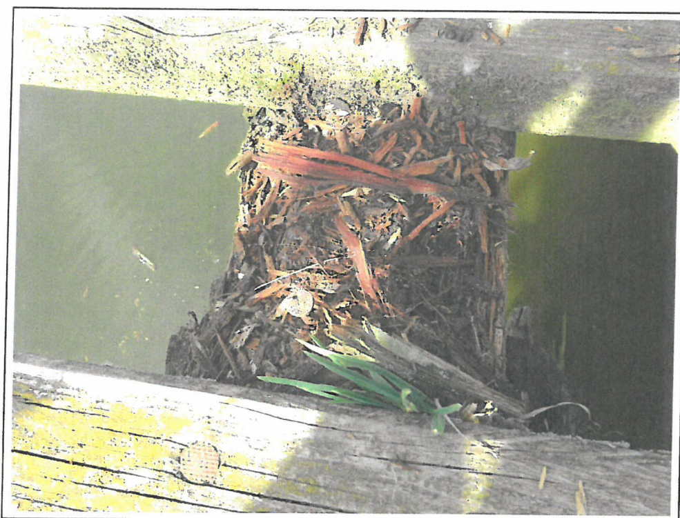
Bohle komplett lose, darunter Hauptträger mit erheblicher Querschnittsminderung
