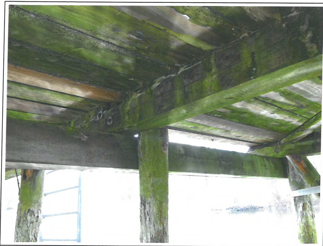
Plattform Pfahl vorn Mitte: Ungenügendes Auflager des Hauptträgers
