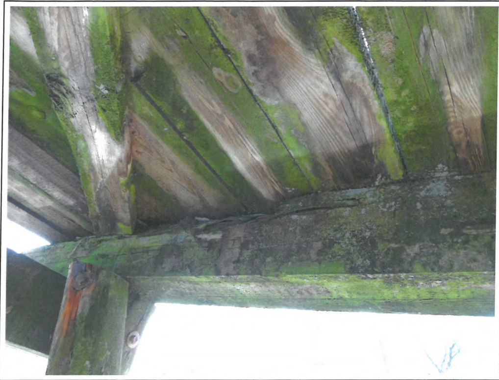
Hauptträger unter Plattform (links) verfault
