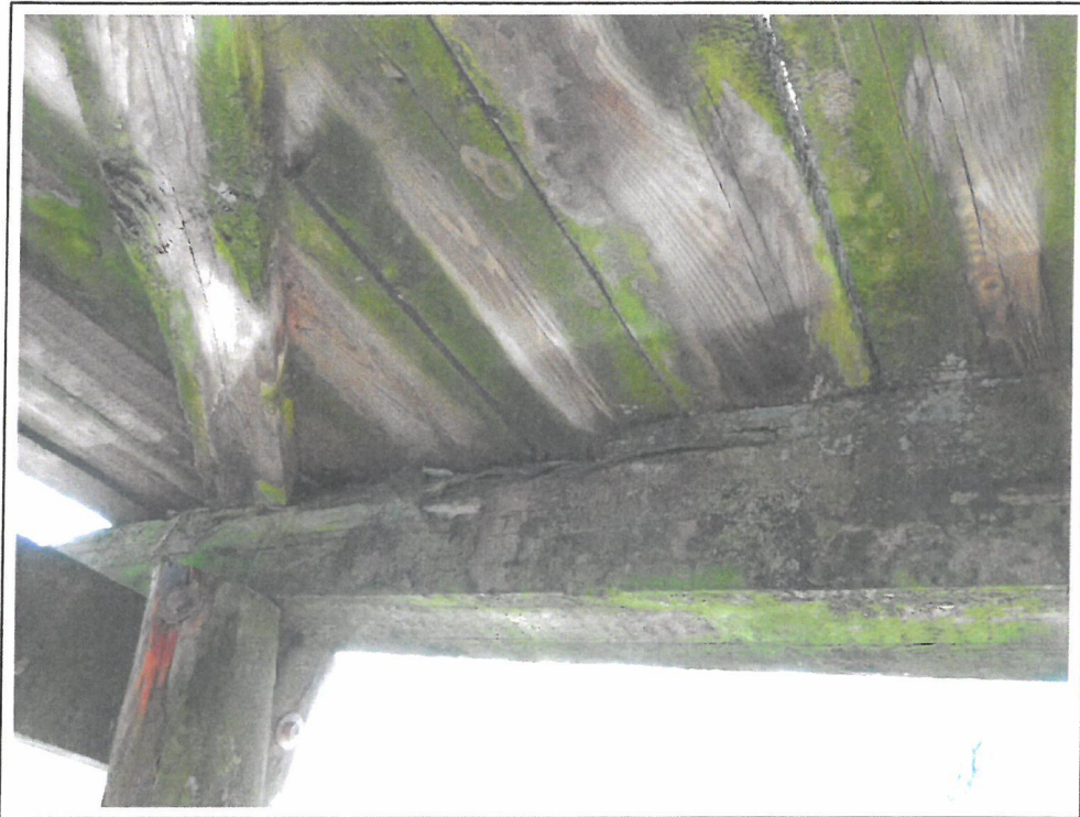
Hauptträger unter Plattform (links) verfault
