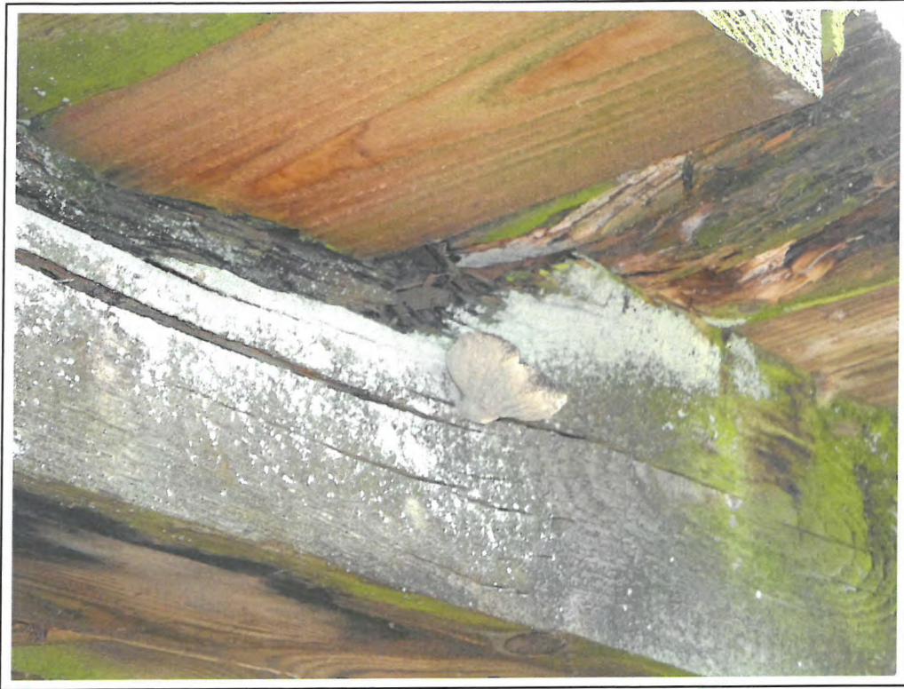
↑ Detail Pilzbefall Hauptträger
