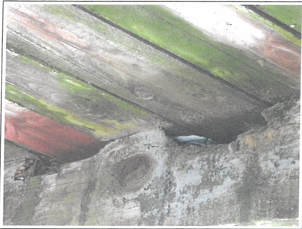
Detail verrotteter Hauptträger mit Pilzbefall an Unterseite Bohle
