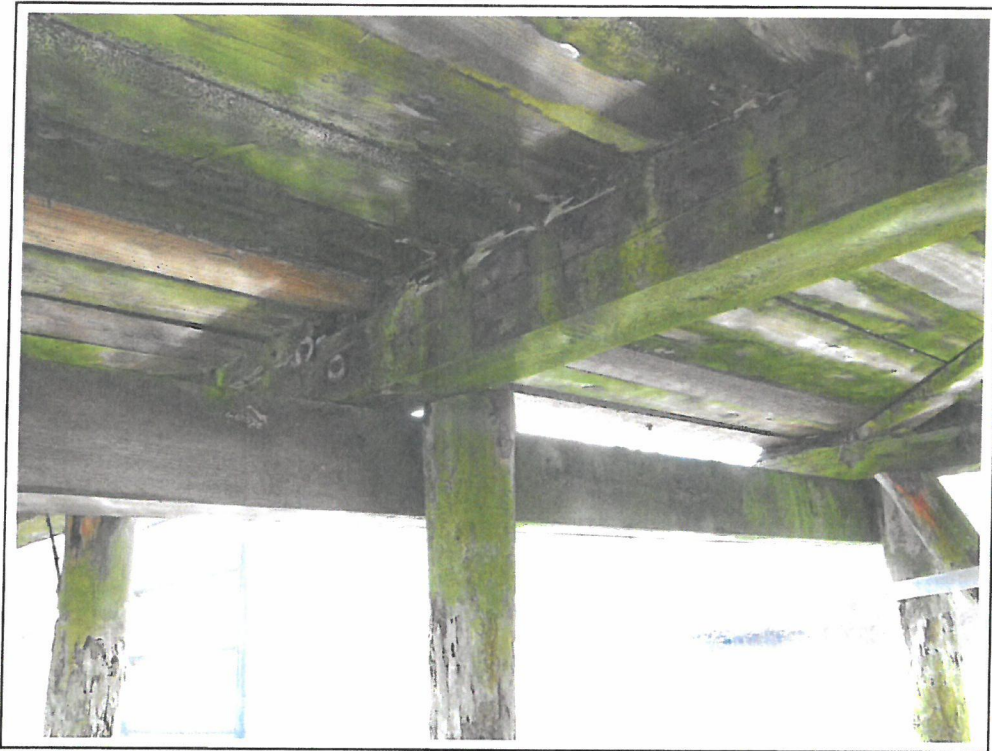
Plattform Pfahl vorn Mitte: Ungenügendes Auflager des Hauptträgers
