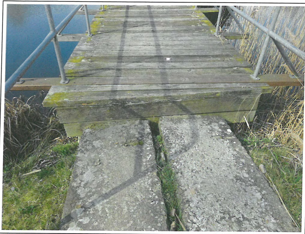
Zugang – Höhenunterschied 25 cm, Spalt zwischen Betonplatten
