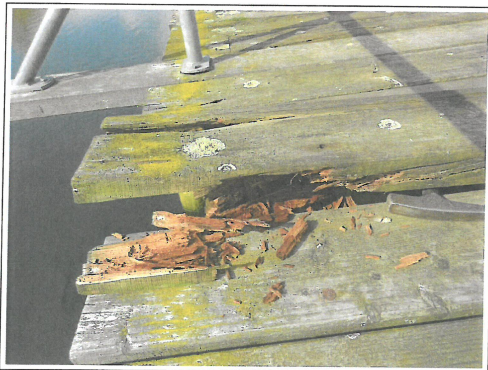
Morsche Bohle, darunter verfallter Hauptträger
