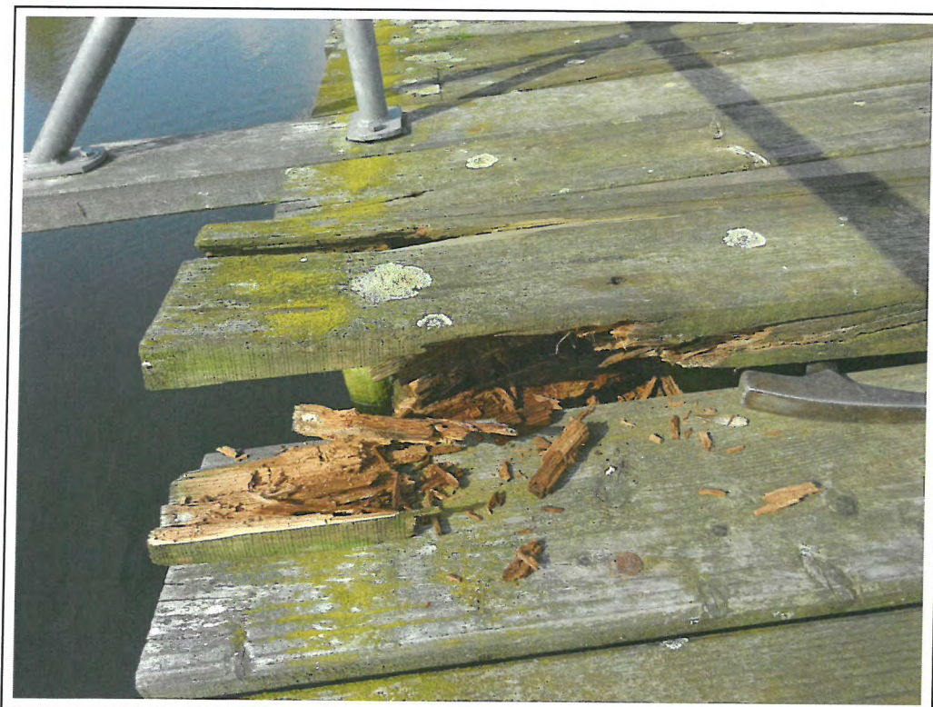
Morsche Bohle, darunter verfallener Hauptträger
