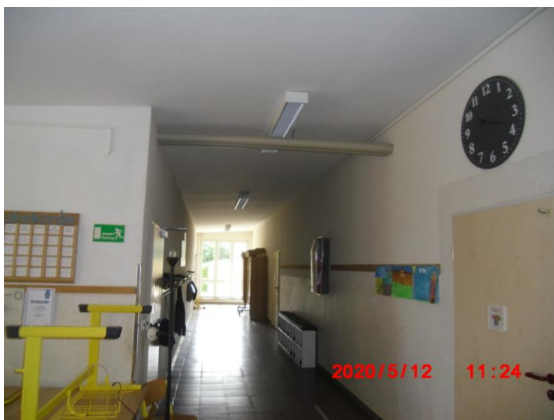
Linker Flur- eine Lampe muss versetzt werden, befindet sich derzeit genau über den Heizungsrohren
