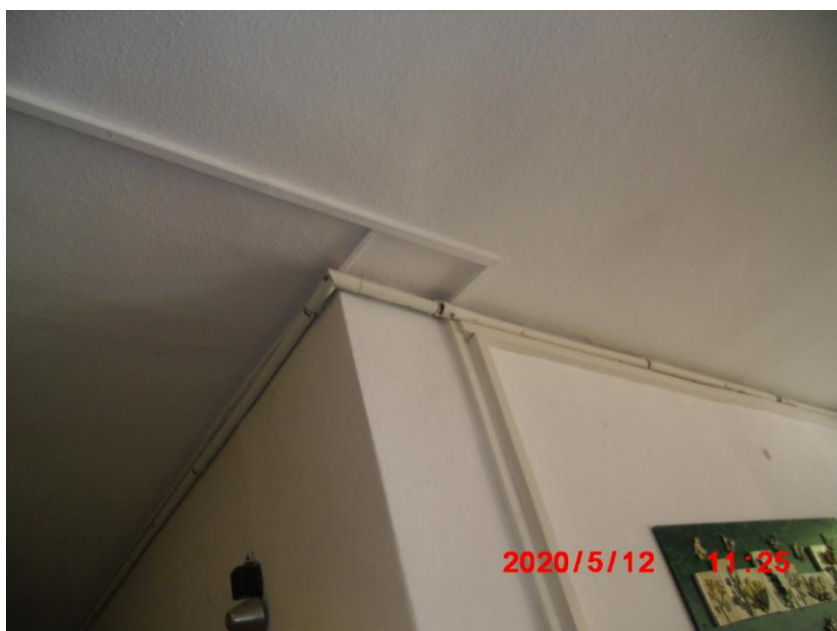
Auf der rechten Seite müssen 4m Kabelkanal umverlegt werden (in die Deckenebene)
