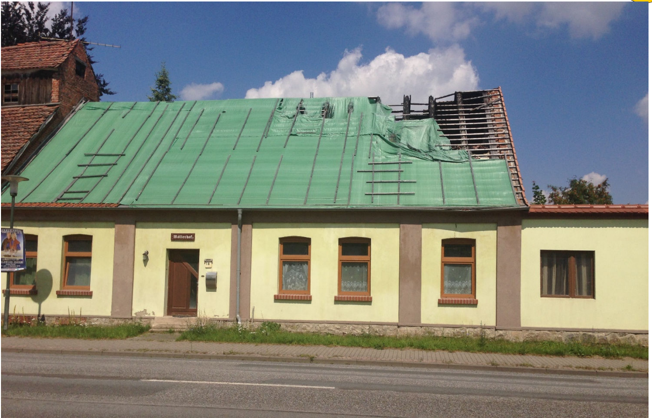
Dorfstraße 18: im Bestand gefährdet, komplett leerstehend (Brandruine)
