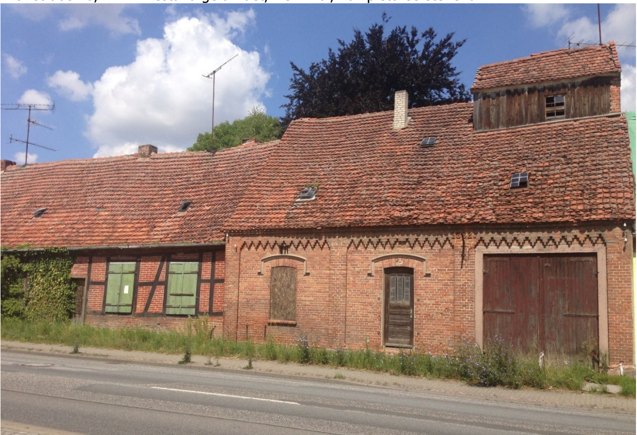
Dorfstraße 19: im Bestand gefährdet, Denkmal, komplett leerstehend
