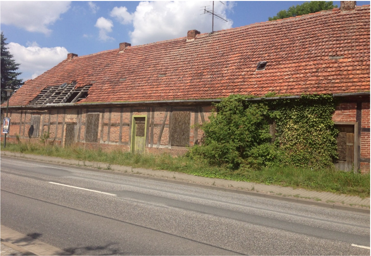
Dorfstraße 20,21: im Bestand gefährdet, Denkmal, komplett leerstehend
